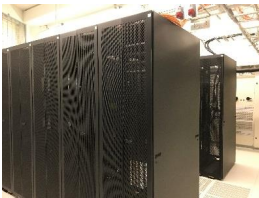
Erikoisuutena valmis laitetila kaasusammutuksella
